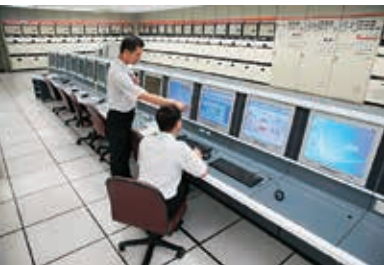
中央監控室 24 小時管控能源效率。
